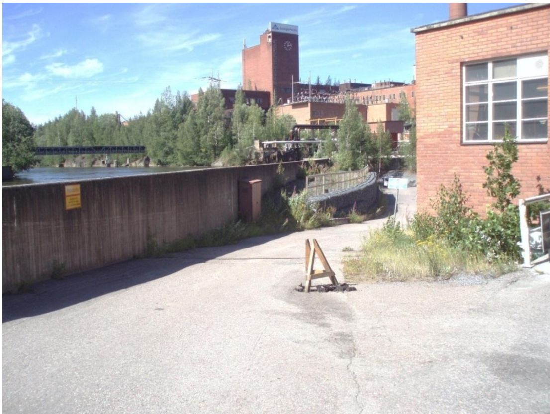
Kuva 6: Nokian tehdasalueen suojapato. Eroosion johdosta pihalle muodostunut vajoama ja taustalla kivikorein vahvistettu padon osa. (Kuva: Mikko Sulkakoski)
