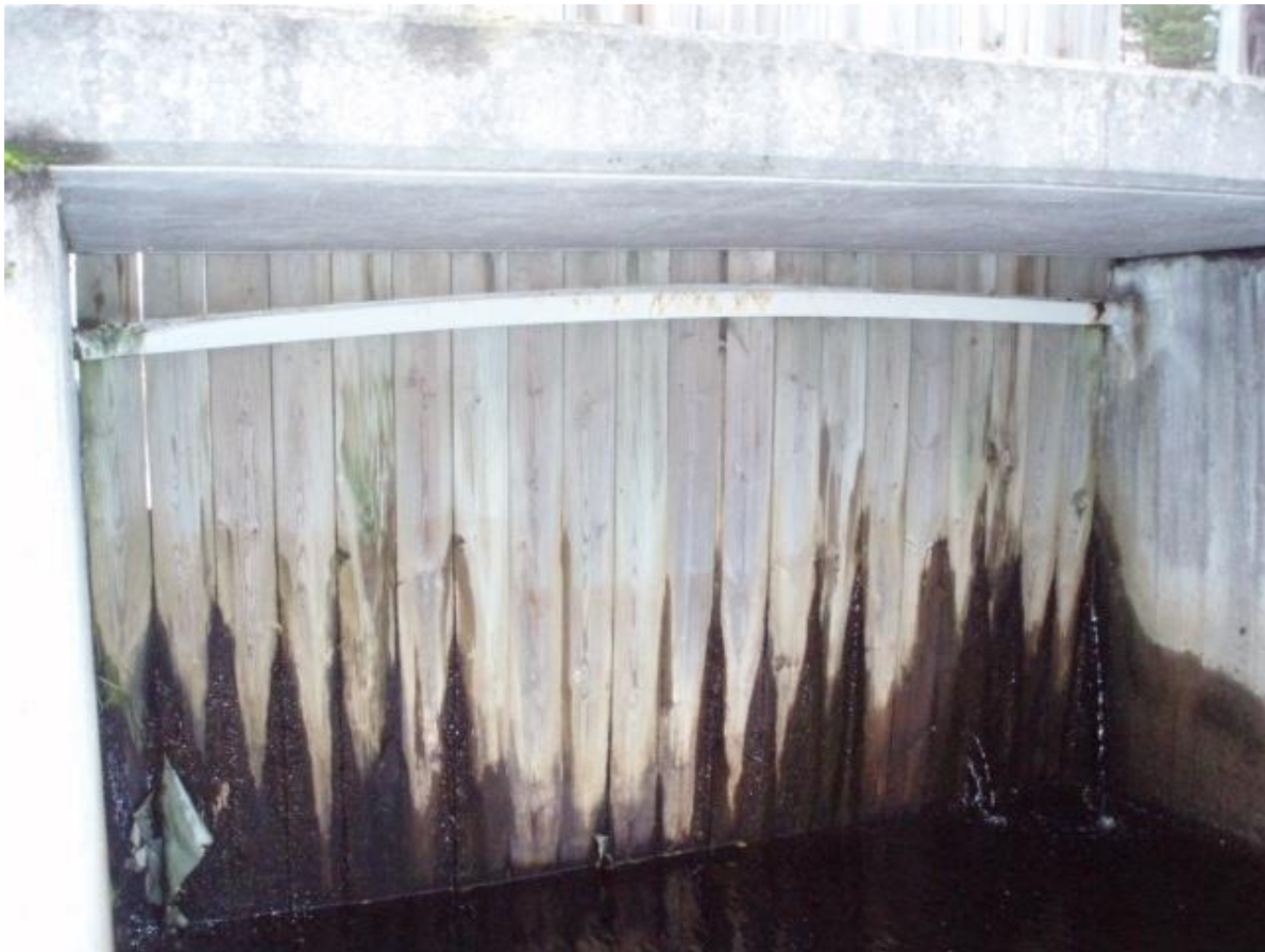
Kuva 5: Killinkosken säännöstelypadon neulojen takainen taipunut tukipalkki. Neulat ovat alkaneet kuormittaa padon betonikantta. (Kuva: Mikko Sulkakoski)
