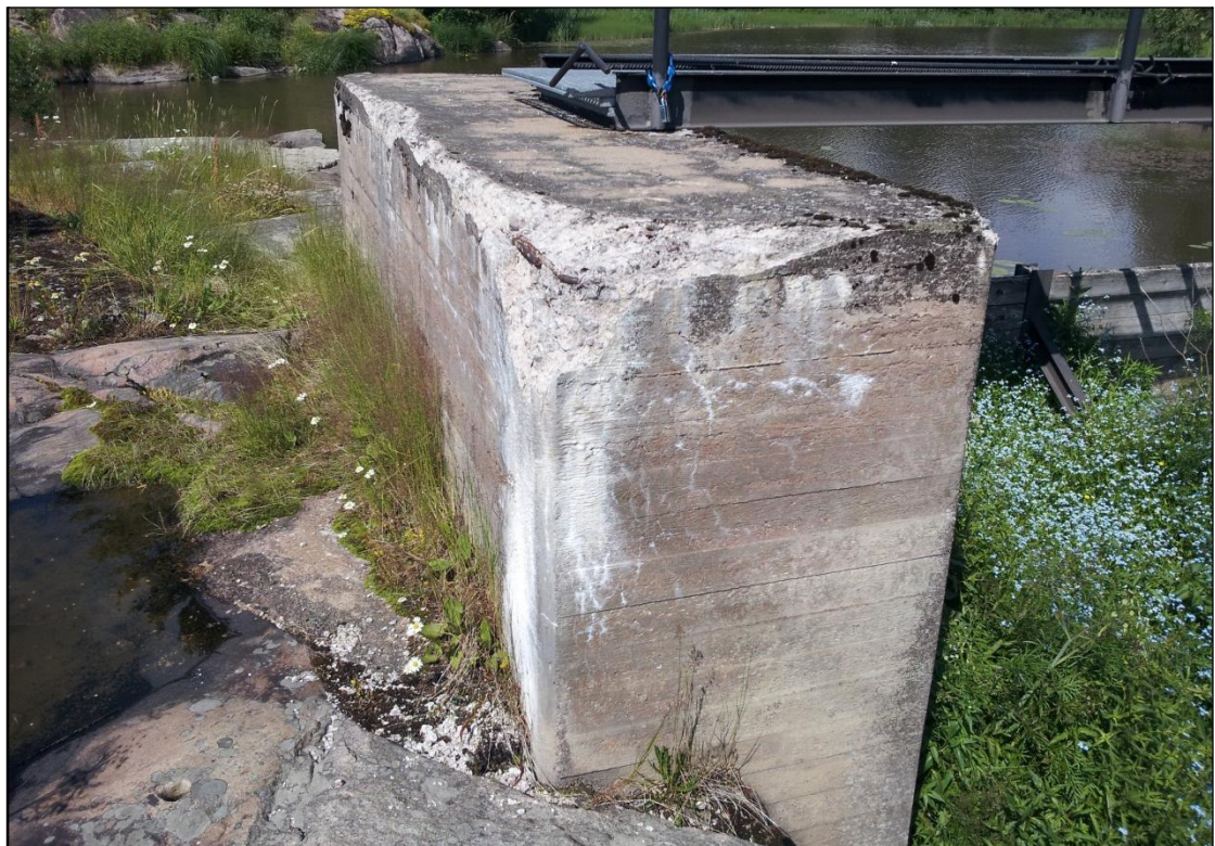
Kuva 32. Rapautunutta betonia Tjusterbynskosken padolla Porvoossa.
