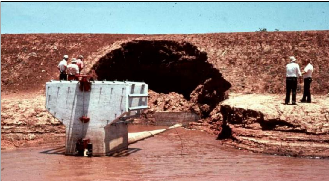
Kuva 16. Sisäisen eroosion sorruttama maapato.
