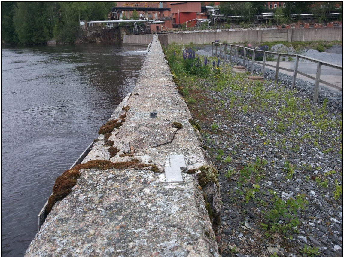
Kuva 54. Tehdassaaren eteläinen pato kasvavan paaluluvun suuntaan kuvattuna, noin paalulta 195. Patolohkoissa on havaittavissa selvää hammastusta. Oikealla kaiteen takana nähtävissä padon tukemiseksi vuonna 2004 valmistunut kivikorirakenne.
