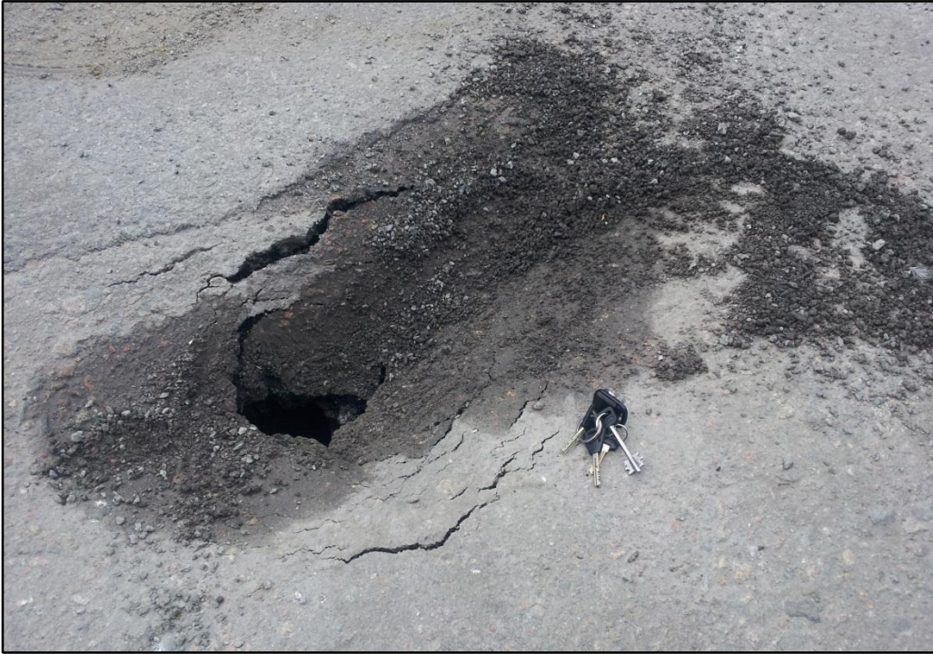
Kuva 55. Toukokuussa 2013 tehtaan alapihalle ilmestynyt noin metrin syvyinen syöpymä, joka havaittiin päällysteen pettäessä trukin pyörän alla.
