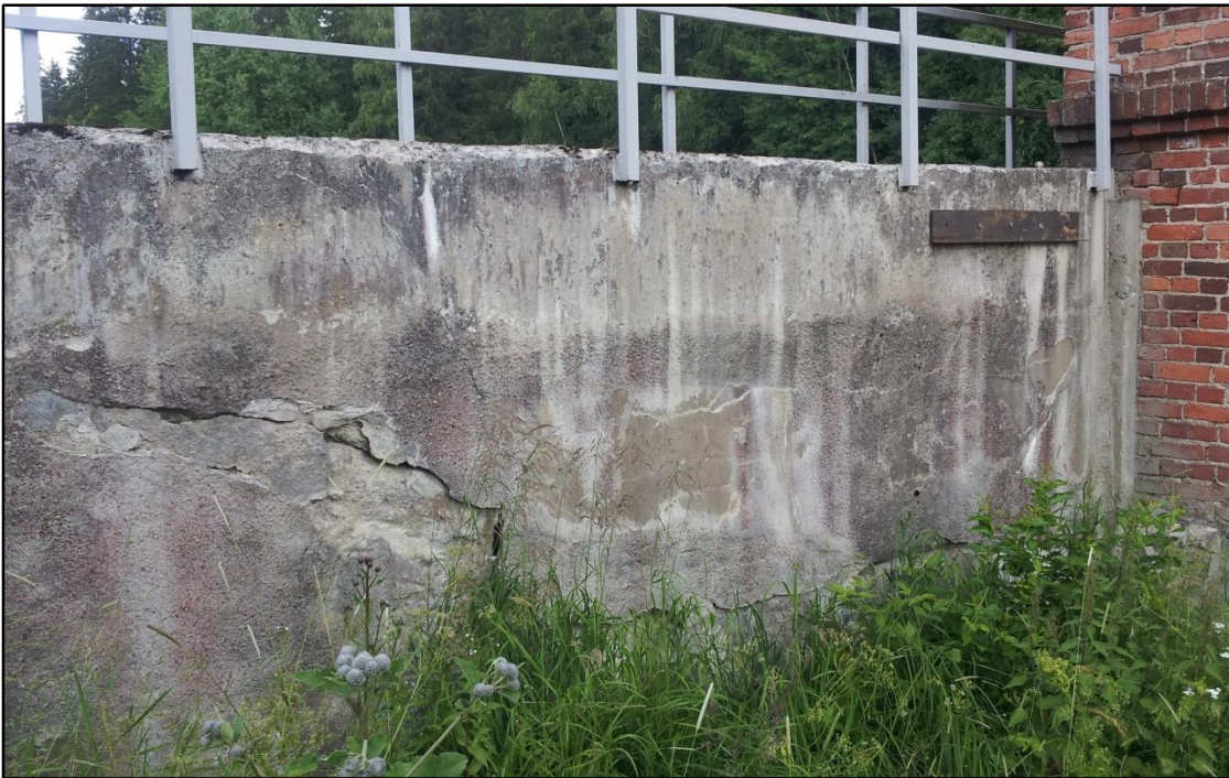
Kuva 33. Halkeamia Vääräkosken voimalaitospadolla Orimattilassa.
