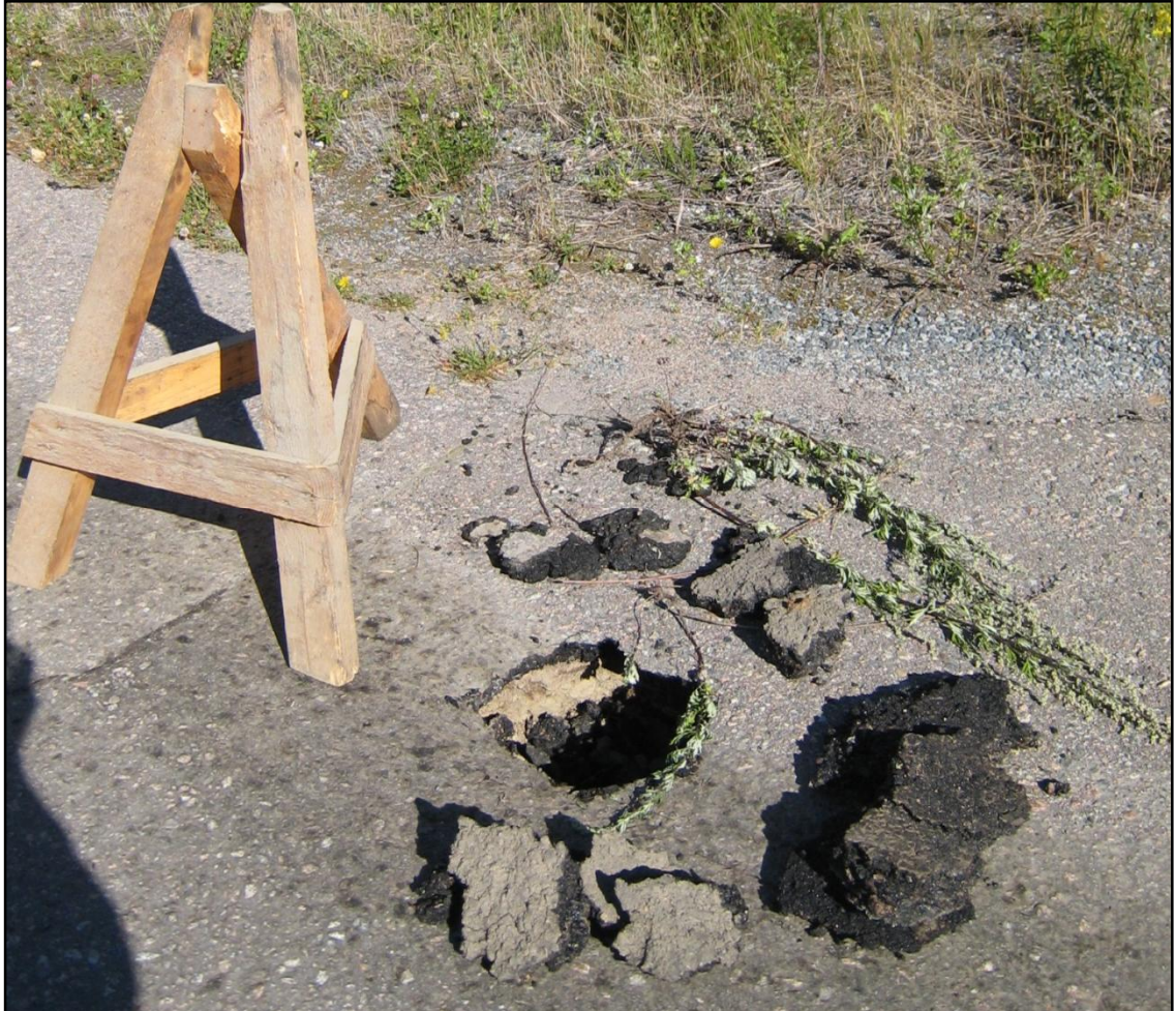
Kuva 52. Tehtaan ajoluiskaan vuonna 2008 ilmestynyt syöpymä ja päällystevaurio. (Kuva: Hannu Kylänpää)
