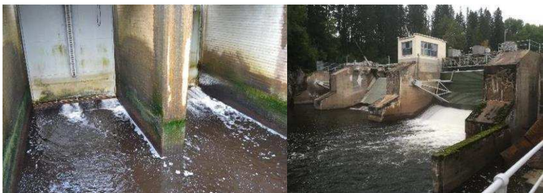
Kuva 16. Vuotoja voimalaitoksen alapuolella luukkujen ollessa kiinni.
